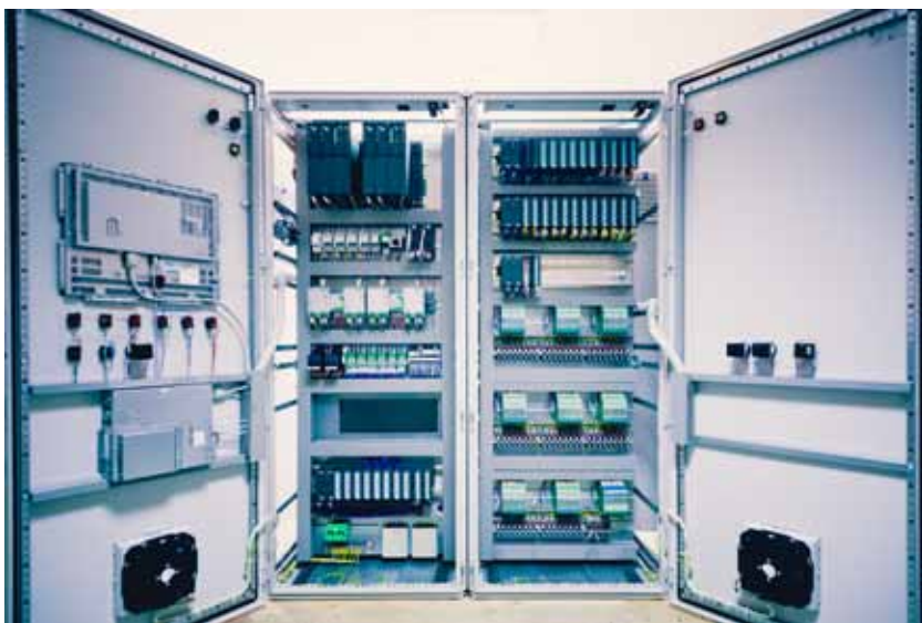
▲ Шкаф ТАиУВО ГА1 Саяно-Шушенской ГЭС
